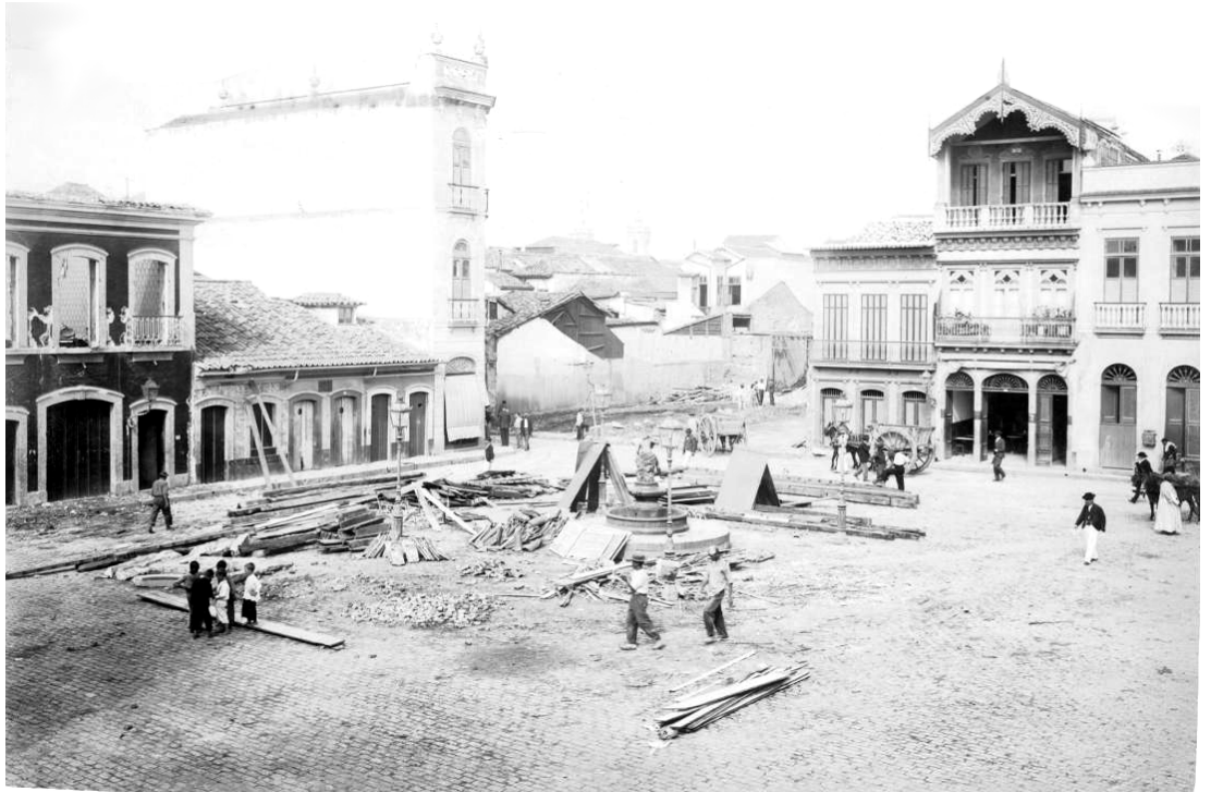
Figura 10: Largo de São Domingos durante as obras da Rua do Sacramento (1903). Com a abertura da Av. Presidente Vargas o Largo desapareceu. Fonte: Arquivo Histórico do Museu da República (foto de Augusto Malta)
